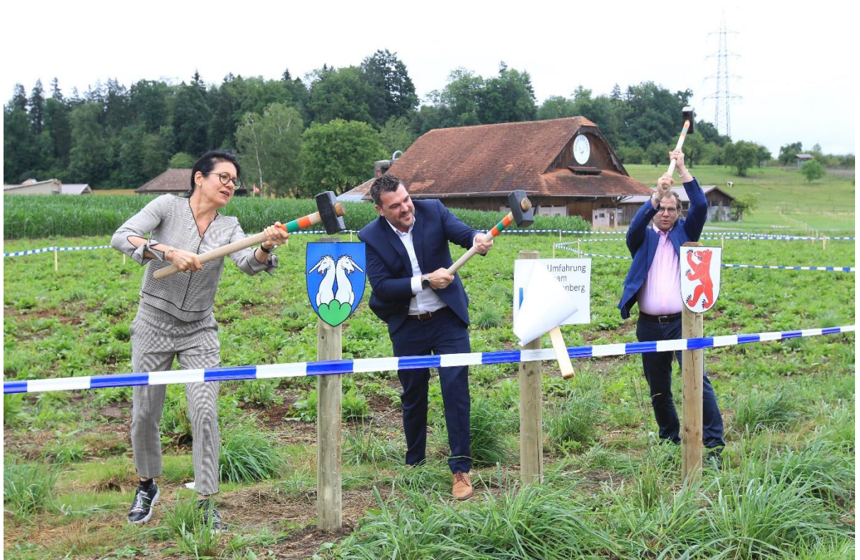
Renate Huwyler, Florian Weber und Georges Helfenstein (von links) schlagen zum offiziellen Start der Bauarbeiten zur Umfahrung Cham–Hünenberg drei Pflöcke ein
