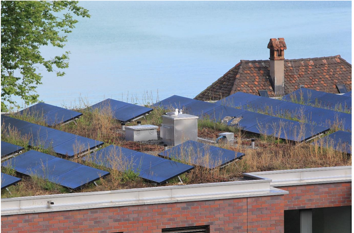
Um Eigenstrom zu erzeugen, werden in der Regel Photovoltaikanlagen installiert, wie hier im Roost in Zug.
