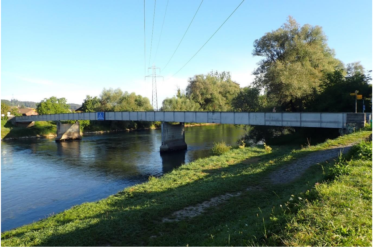
Die Reussbrücke Mühlau muss saniert werden.
