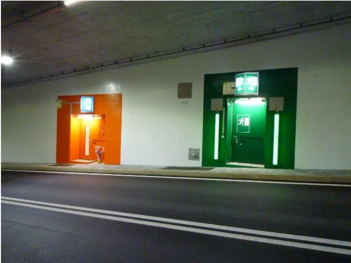
Der Tunnel Geissbüel der Tangente Zug/Baar verfügt über zahlreiche Sicherheitsanlagen, die periodisch überprüft werden müssen.
